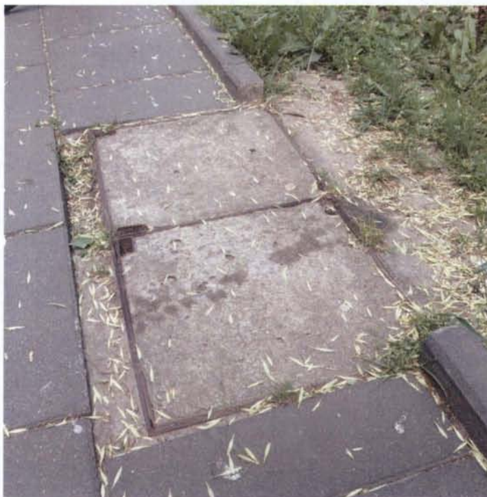
Rysunek 27.4. Brak wypełnienia przestrzeni pomiędzy chodnikiem a płytami studzienki
