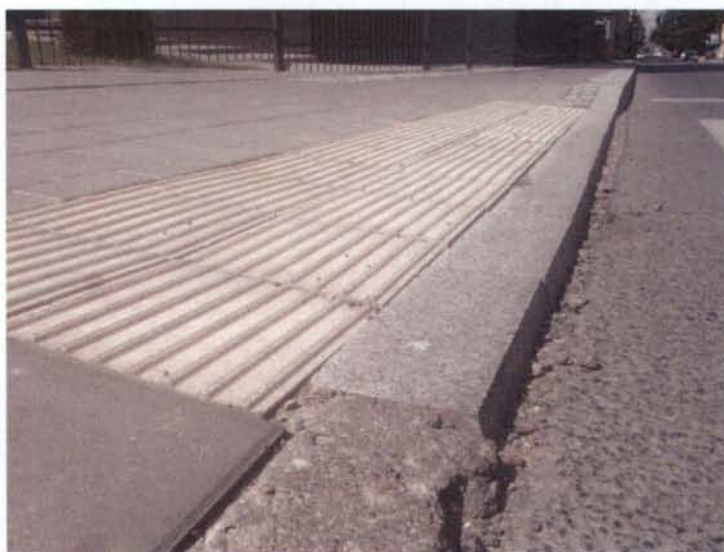
Rysunek 27.11. Nieprawidłowo ułożone płytki kierunkowe – nie wskazują kierunku przejścia
