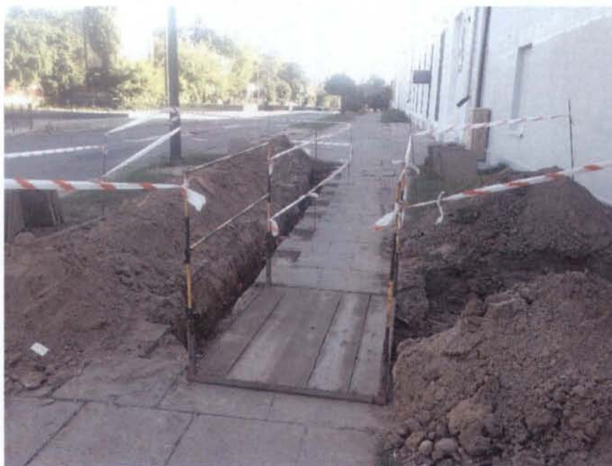
Rysunek 27.13. Nieprawidłowy sposób zabezpieczenia robót drogowych – stosowanie taśm jest niedozwolone. Niezgodnie z przepisami.
