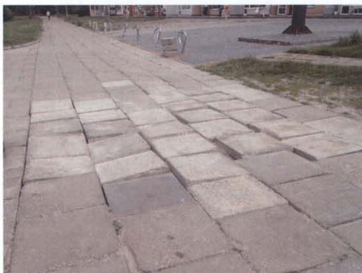
Rysunek 27.3. Źle zamontowana nawierzchnia chodnika po remoncie
